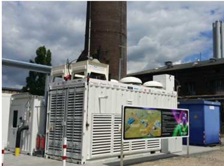
Figure 3 - L'électrolyseur PEM de ITM Power (300 kW)
