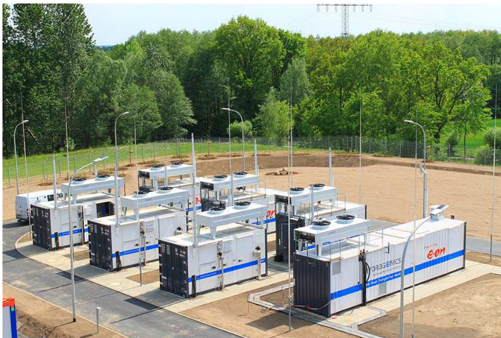
Figure 2 - L'installation "Power-to-Gas" de E.ON
