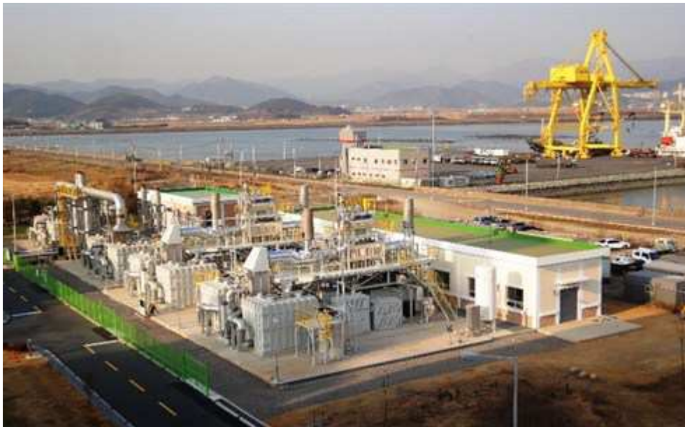
Figure 5 - La centrale de Bridgeport (14,9 MWe)
