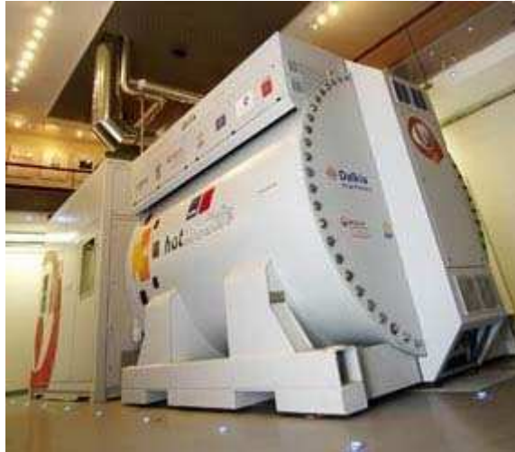
Figure 4 - La pile MTU à l'OPAC de la Porte Brancion (Paris)
